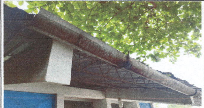
Foto 2: Estado actual de canal y bajadas de agua en módulo de baños
