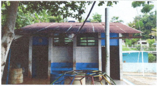
Foto 1: Estado actual del techo en módulo de baños
